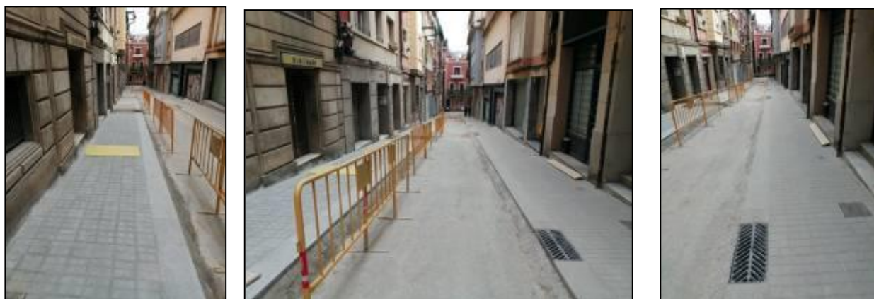
Fig.27.- FINAL PRIMERA FASE: Vista general de les dues voreres del carrer de la Granja, amb els panots reposats. Font: Carles Navarro, 2021
