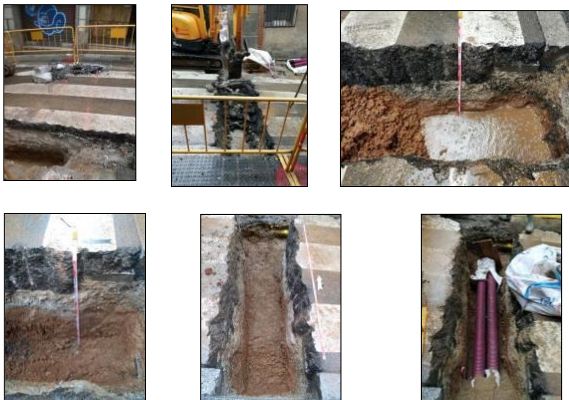
Fig.26.- Diverses vistes del creuament de la RASA 1000 del carrer de la Granja. Font: Carles Navarro, 2021
