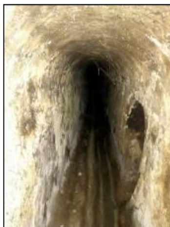
Fig.15.- Vista de l'interior del col·lector central del carrer de la Granja. Font: Marcos de COYNSA, 2021
